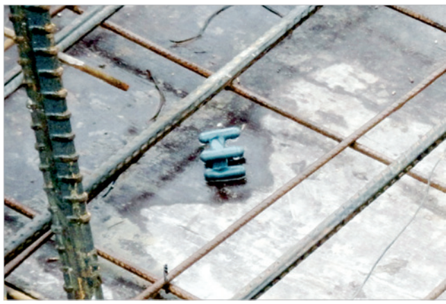
Figura 5 – Espaçador tombado durante um concretagem
