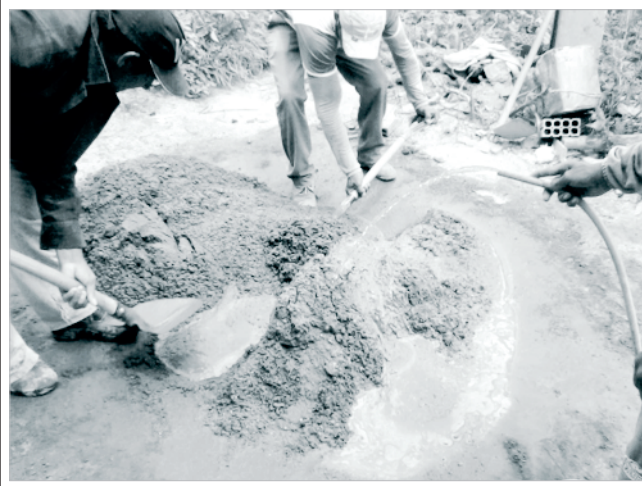
Figura 7 – Adição incorreta de água ao concreto
