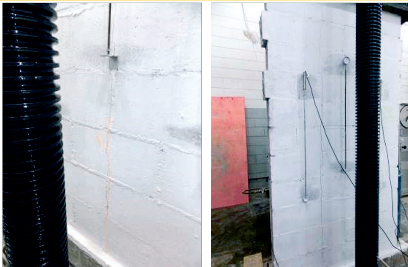
Figura 30 Ilustração da fissuração vertical das paredes Grupo 1 e 2
