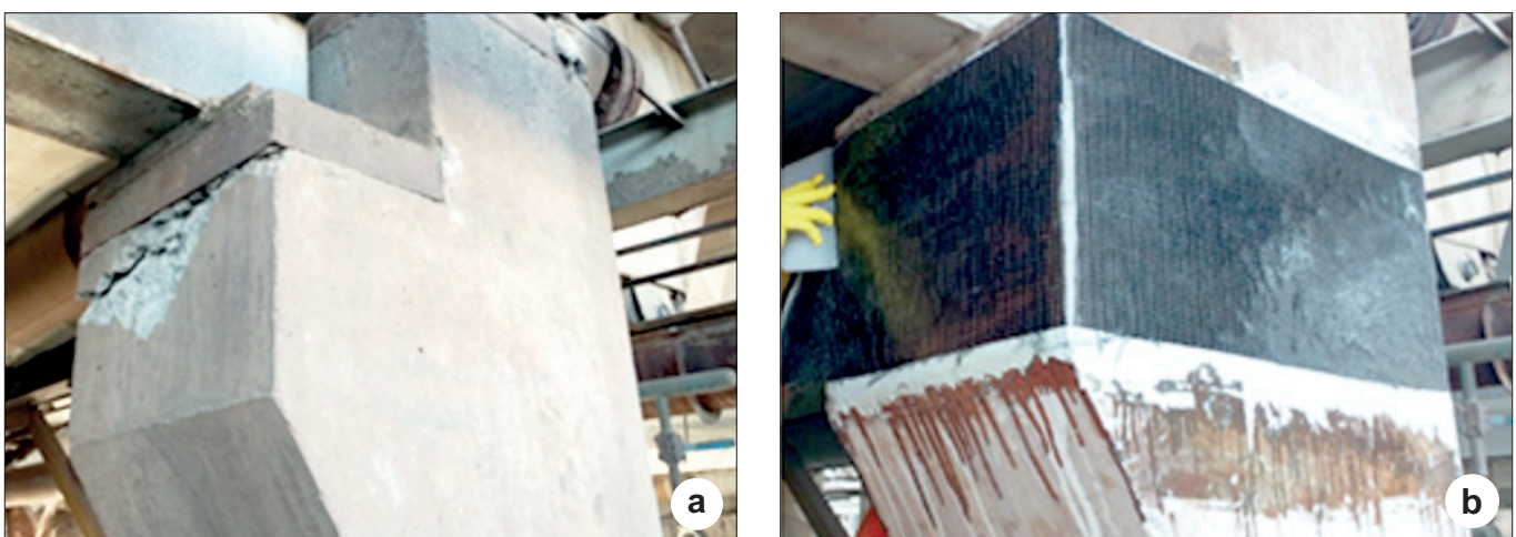
Figura 1 Consolo reforçado com manta de fibra de carbono: a) situação inicial, b) reforço finalizado
