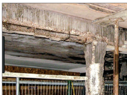
(b) Perda de cobrimento ( sloughing )
