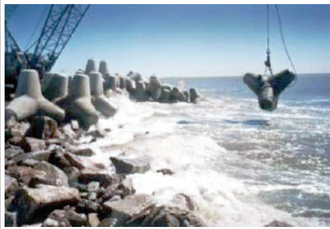
Figura 1 – Montagem dos tetrápodes da obra de ampliação dos molhes da Barra de Rio Grande (fonte: Migliorini, 2011)
