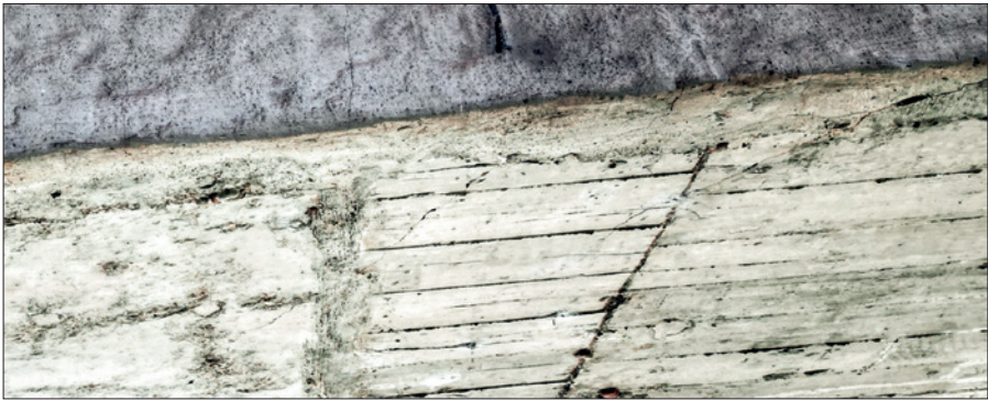
FIGURA 5 FISSURAS DE ESTADO LIMITE ÚLTIMO NA MESA INFERIOR DA SEÇÃO CAIXÃO FONTE: AUTORES
