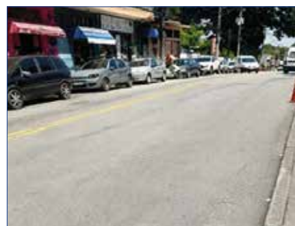
Pavimento asfaltado após 8 anos de uso
