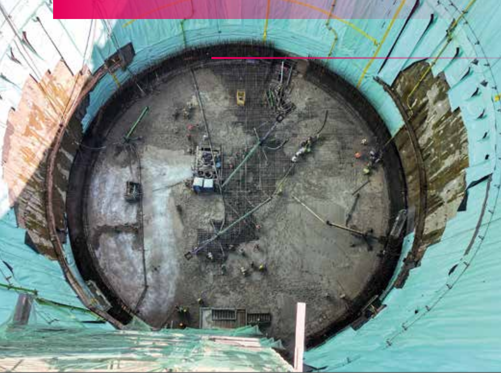
Concretagem da laje de fundo do túnel de acesso da Linha 2 do Metro de São Paulo
