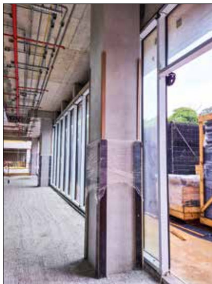
Pilar em concreto aparente do Centro de Ensino e Pesquisa do Hospital Albert Einstein
