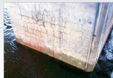
► Figura 2 Fissuras devido à DEF
