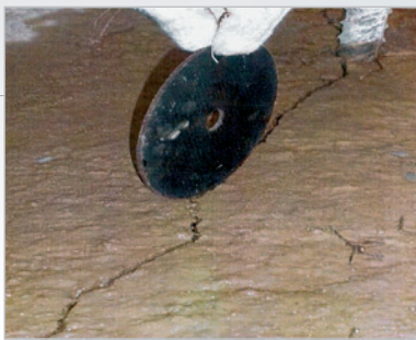
► Figura 1 Fissura em bloco – retração térmica
