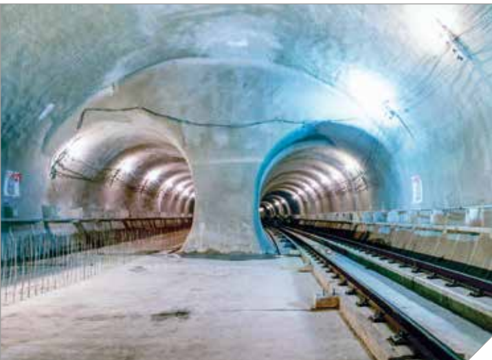
Túnel duplo do Metrô de São Paulo, primeiro construído pelo método NATM para transporte metropolitano no estado
