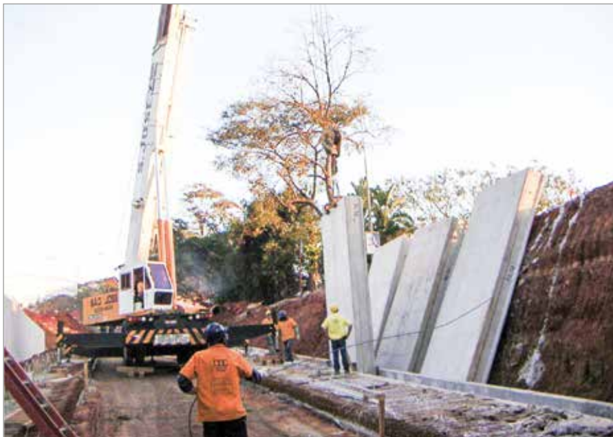
Foto 6 — Montagem das placas pré-moldadas de contenção lateral na entrada e saída do túnel
