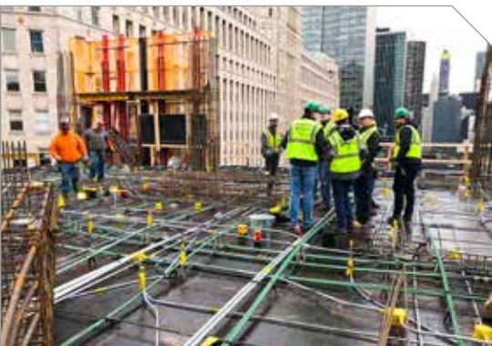
Integrantes da Missão IBRACON visitam edifício em construção na cidade de Chicago
