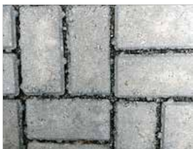
► Figura 3 Peças de concreto com juntas alargadas. Percolação pelas juntas
