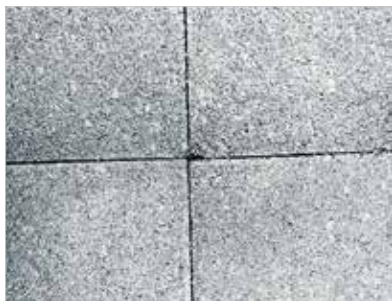
► Figura 6 Placas de concreto poroso. Percolação pelas placas
