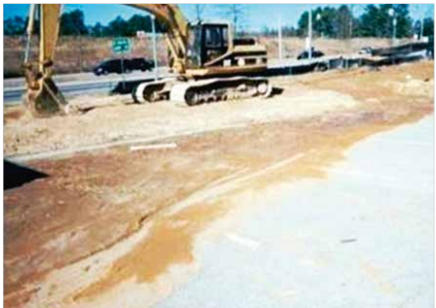
▶ Figura 10 Colmatação causada por tráfego durante a construção (TONG, 2011)
