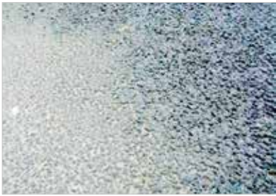
► Figura 11 Falha comum de obstrução causada por escoamento superficial com detritos
