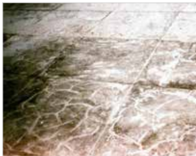
► Figura 2 Microfissuras de retração em piso cimentado (inadequação do traço / ausência de cura)
