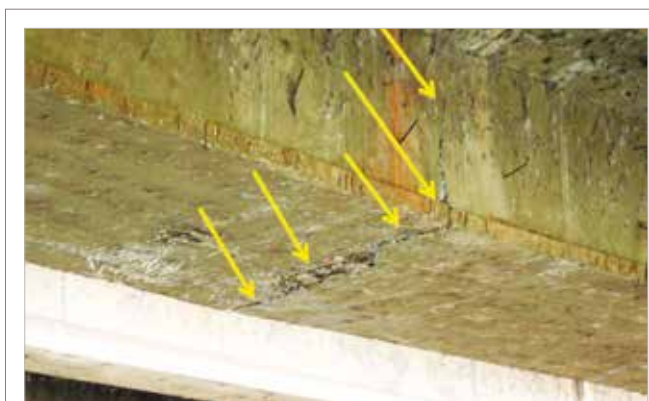
► Figura 4 Vista inferior da viga e destaque da região rompida
