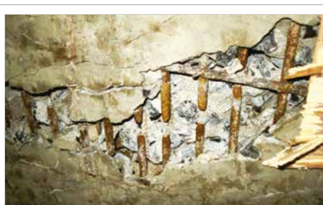
► Figura 5 Detalhe da armadura passiva da viga rompida
