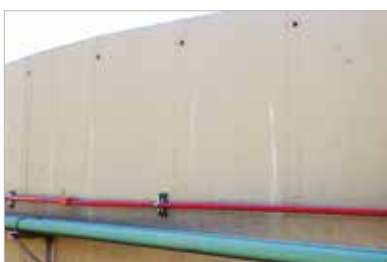
► Foto 3 Detalhe do mesmo tanque da foto anterior revelando a presença de fissuras verticais e vazamentos
