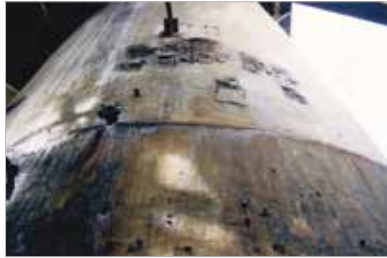
► Foto 1 Reservatório de concreto armado deteriorado por corrosão de armaduras
