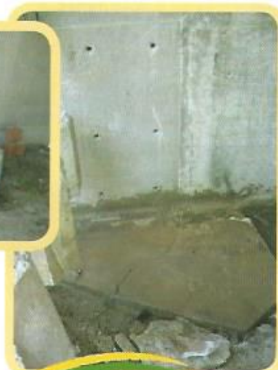
Detalhe de fissuras em edifícios de Recife
