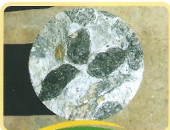
Detalhe de concreto extraído de bloco de fundação, onde se vê gel da RAA
