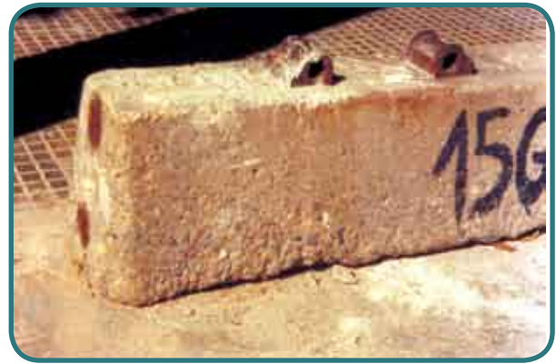
Fig 08 - Detalhe do desgaste superficial de um dormente
