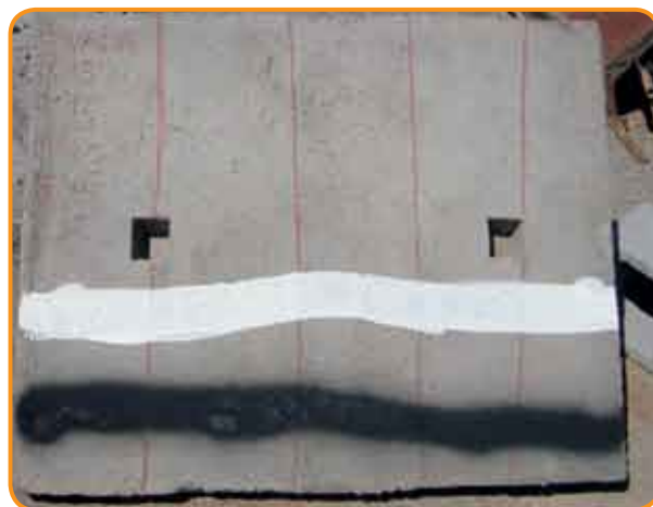
Foto 3 – Peça de concreto com aplicação de tinta arquitetônica comum (látex PVA) e grafitti
