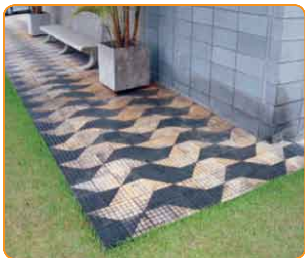
Foto 1 – Ladrilho hidráulico antes da limpeza/recuperação
