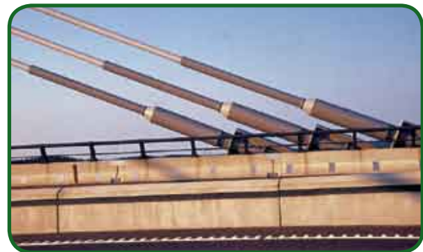
Fig. 7 – Stay cables equipped with friction dampers (Uddevalla Bridge)
