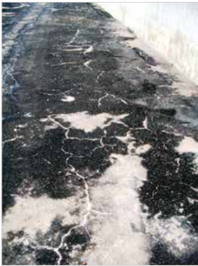
► Figura 2 Fissuração na barragem
