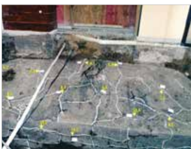
► Figura 12 Mapeamento das trincas e fissuras
