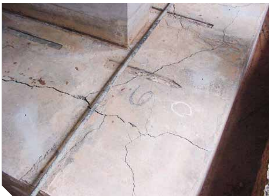
Topo de bloco de fundação com fissuras devidas à RAA
