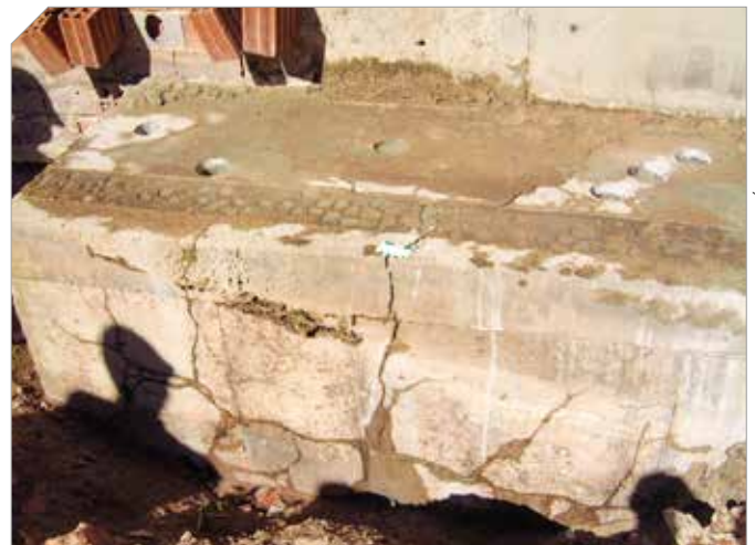
Bloco de fundação de edifício em Recife afetado por RAA, onde se observa quadro fissuratório
