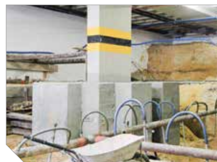
Bloco concluído, depois de seu envelopamento com concreto com microsilica e pintura impermeabilizante
