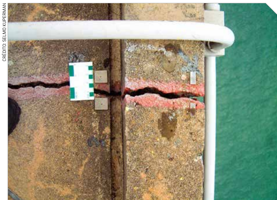
Viga e laje de uma barragem no Brasil afetada com RAA, nas quais se vê a abertura de fissura provocada
