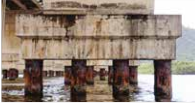
► Figura 2 Fissuração nos blocos
