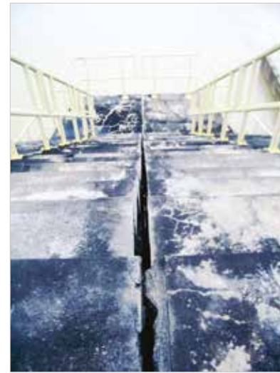
► Figura 3 Abertura de junta nos pilares
