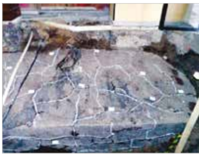
► Figura 1 Sapata SP (10+11) com fissuras marcadas com giz
