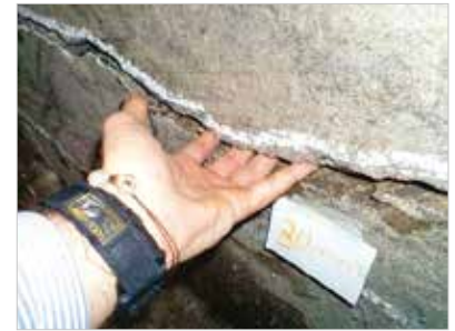
► Figura 13 Fissura na sapata com abertura de 30 mm
