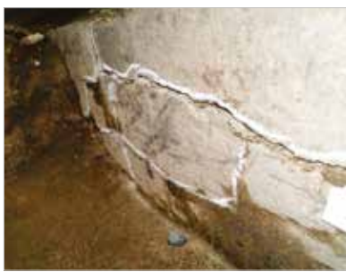
► Figura 2 Sapata (10+11) com fissuras marcadas com giz na sua face lateral
