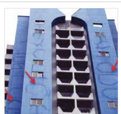
▶ Foto 11 Vista desse tipo de fissura ao longo dos pavimentos de um edifício
