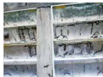
► Figura 4 Corrosão de armaduras em degraus da escada
