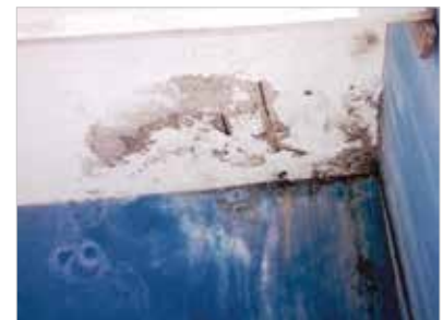
► Figura 8 Manchas de umidade em laje
