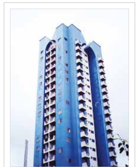
► Foto 2 Fissuras nas regiões de ligação da alvenaria com a estrutura e nos cantos das aberturas
