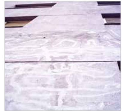
► Foto 5 Rasgos ao longo das fissuras
