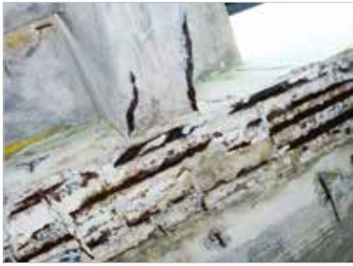
► Figura 5 Corrosão de armaduras em vigas
