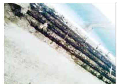
► Figura 10 Corrosão de armaduras em viga com estribo rompido
