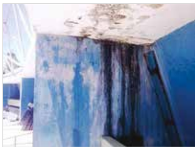
► Figura 6 Pilar afetado por bolor
