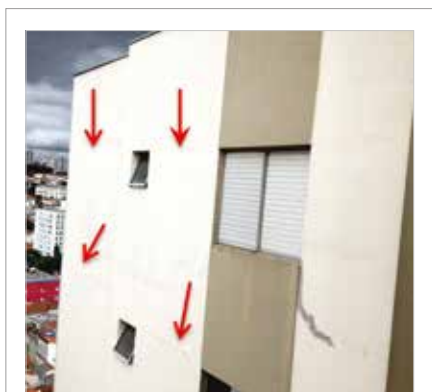
► Foto 7 Fissuras na região de fixação nos últimos andares dos edifícios
