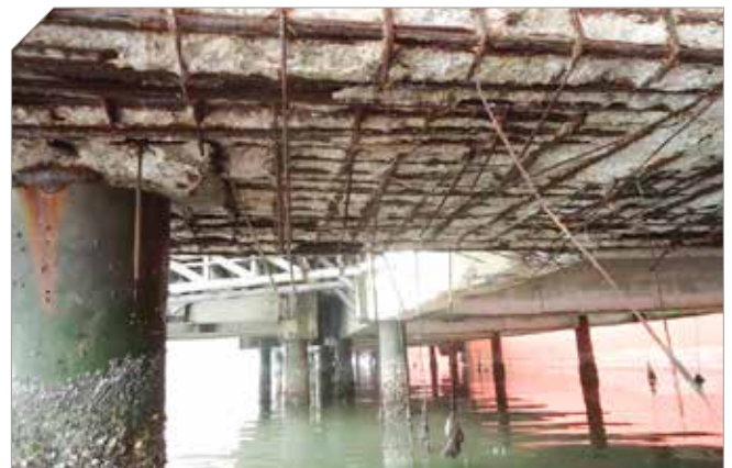
Danos severos por corrosão de armaduras, incluindo o seccionamento das barras, em pier de atracação
