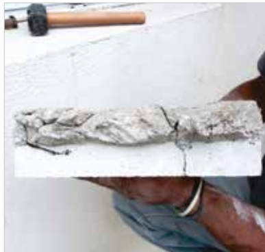
► Foto 16 Nota-se que a espessura do emboço é superior a 30mm, de modo que argamassa trabalha como um conjunto monolítico independente da base, necessitando de reforço com telas metálicas
