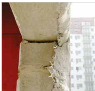
▶ Foto 10 Falhas na região de fixação: telas plásticas não resistem às tensões a 45° e deformam-se. A região de fixação deve ser 100% preenchida com argamassa “farofa” e deve ser empregado chapisco adesivo nos fundos das vigas, e não chapisco rolado
