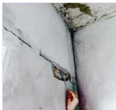
► Foto 8 Nota-se que essas fissuras ocorrem às vezes durante o período de obra (gestação)
