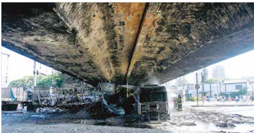
► Figura 1 Vista inferior do vão central do Viaduto Santo Amaro, após ser atingido por incêndio
