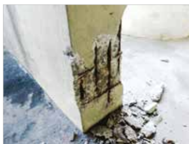
► Figura 3 Corrosão de armaduras em base de pilar
