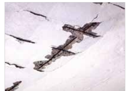
► Figura 9 Corrosão de armaduras em laje da cobertura
