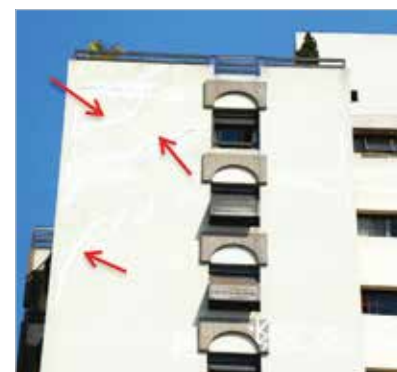
► Foto 9 Detalhe das fissuras inclinadas em face das movimentações térmicas da laje de cobertura
