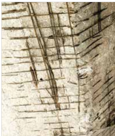
► Figura 8 Detalhes da região do viaduto mais afetada pelo incêndio, onde é possível ver as bainhas de protensão
