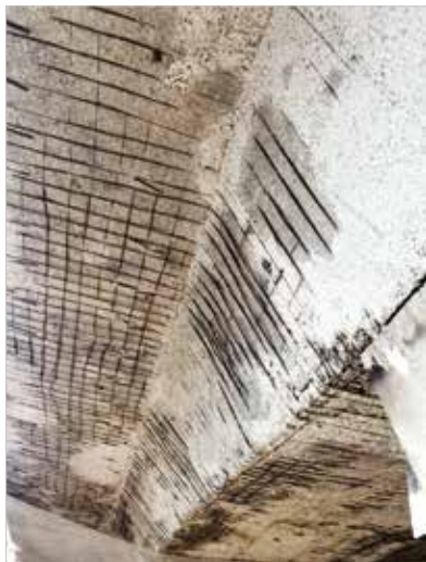
► Figura 7 Aspecto da parte do viaduto mais danificada pelo incêndio
