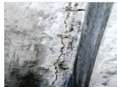
► Figura 2 Corrosão de armaduras em arquibancada
