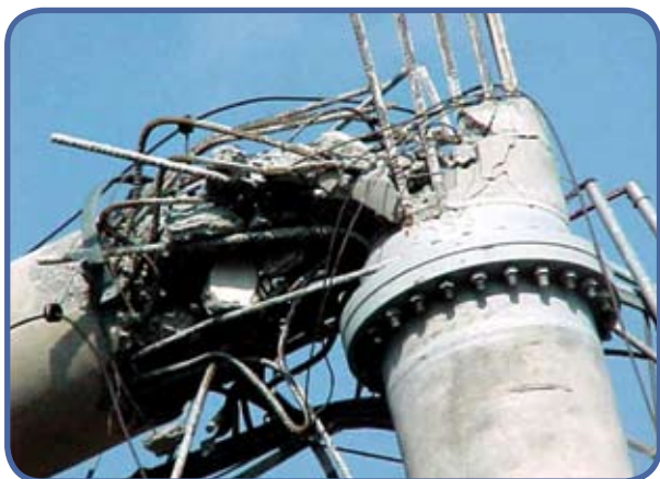
Figura 3 – Vista da região de ruptura de poste de concreto armado, centrifugado e pré-moldado
