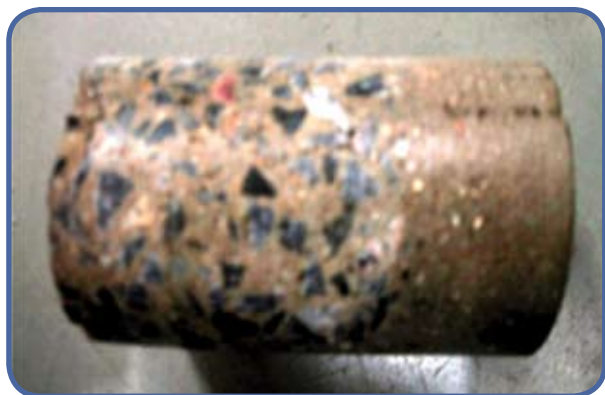
Figura 7 – Heterogeneidade do concreto centrifugado utilizado nos postes
