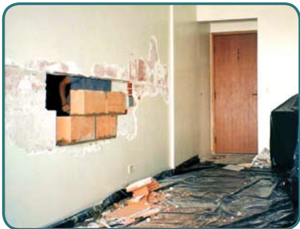
Ruptura de parede divisória
