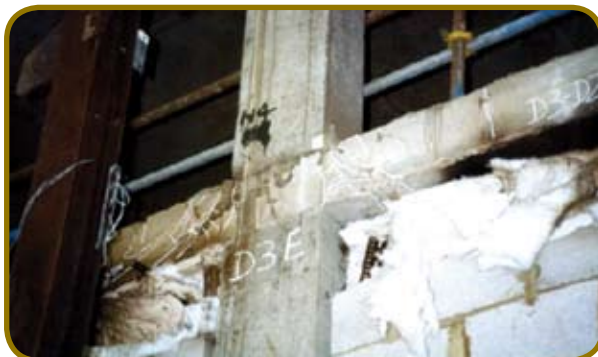
Figura 15 - Fissuração ao redor do pilar
