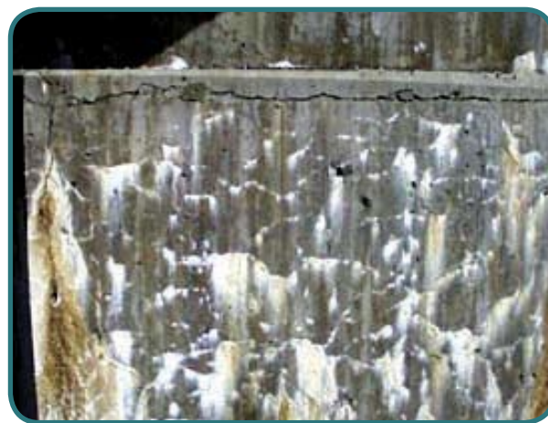
Fissuras causadas pela RAA
