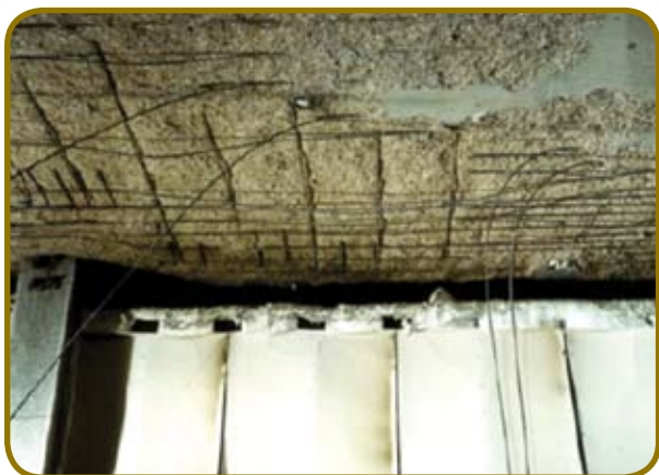
Figura 9 – Efeitos do destacamento da parte inferior da laje do primeiro andar
