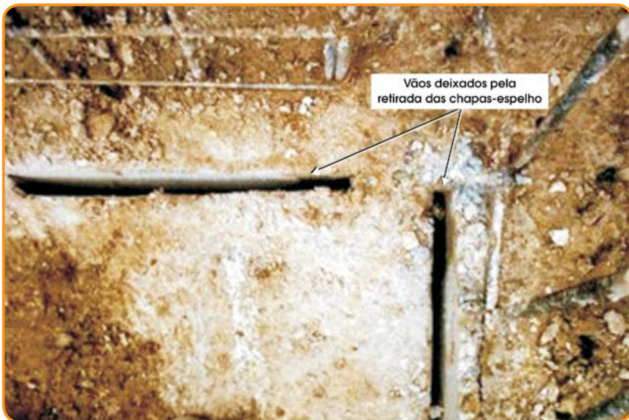
Foto 3 – Detalhe de uma lamela de canto onde foram sacadas as chapas-espelho visto de cima.
