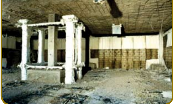
Figura 17 – Foto ilustrativa da área de destacamento
