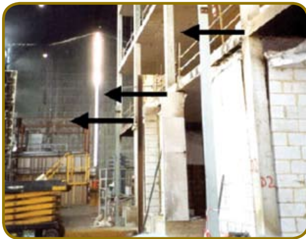
Figura 14 - Extensão do movimento horizontal ocasionado pela expansão térmica da laje
