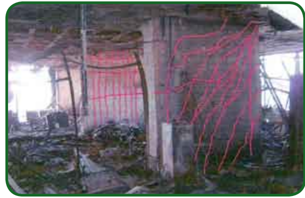
5 – Pilar de concreto armado incendiado
