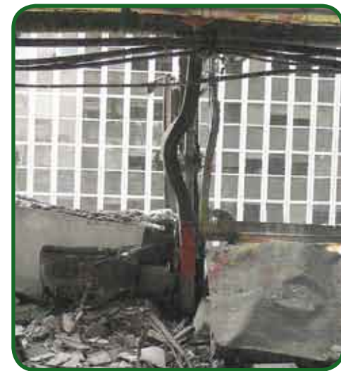
6 – Pilar metálico incendiado
