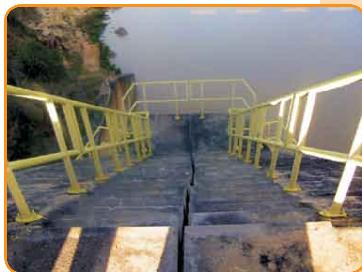
Figura 6 – Abertura de junta de contração em pilar de vertedouro.
