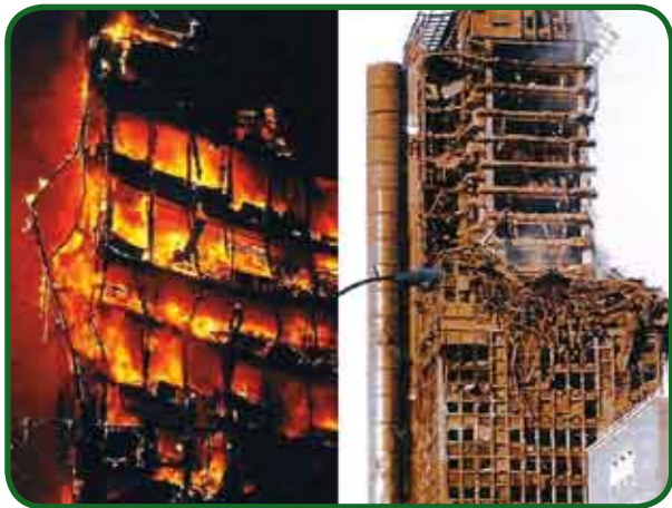
3 – Ápice do incêndio e 4 – Desabamento parcial
