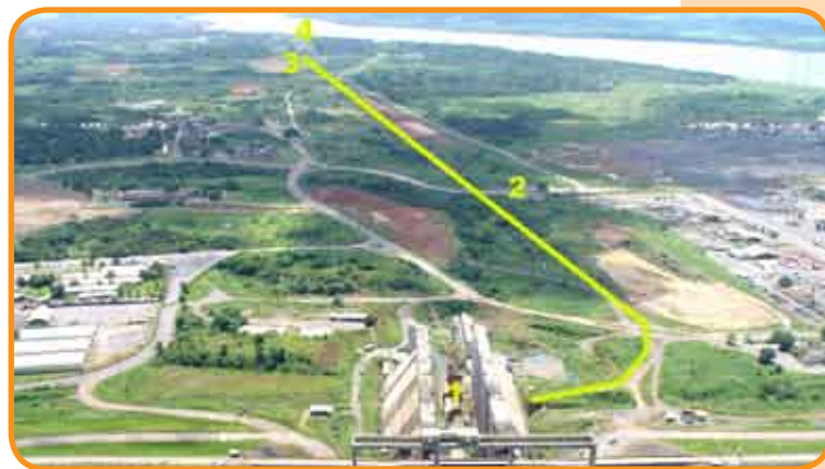
Figura 5 – Arranjo geral das obras do Sistema de Transposição, em Maio de 2003, onde: 1 – Eclusa I; 2 – Eixo do Dique de Terra; 3 – Área da Eclusa II; e, 4 – Canal de Jusante.
