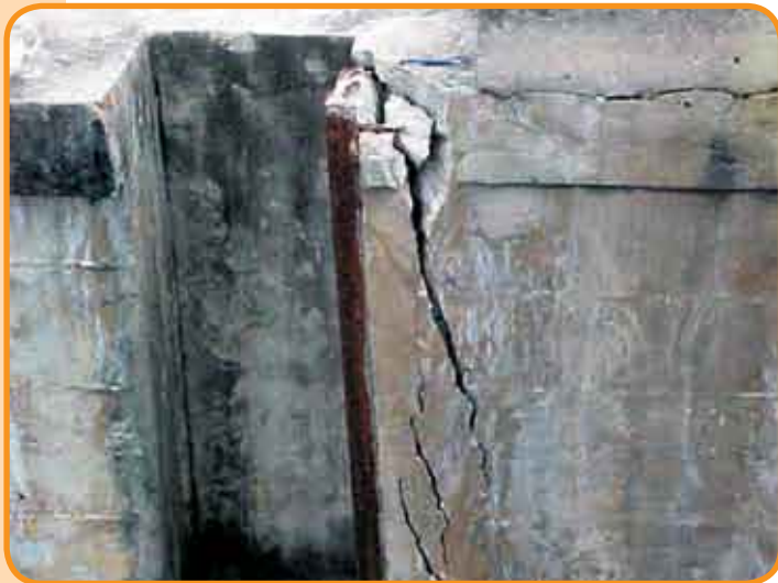
Figura 7 – Fissuração devida à expansão da RAA no concreto restringida pelo perfil metálico em tomada d'água.
