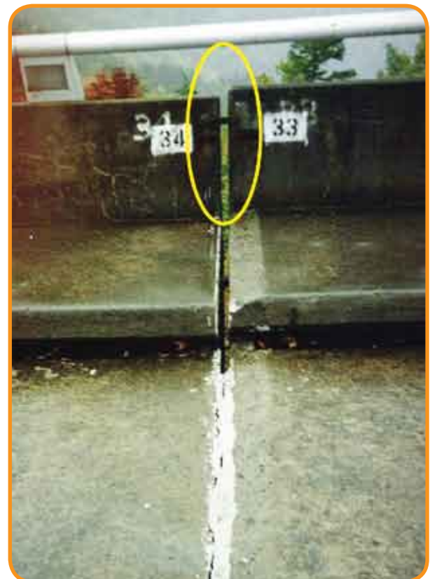
Figura 8 – Desnível entre blocos em crista da barragem Bloco Adjacente ao Vertedouro.
