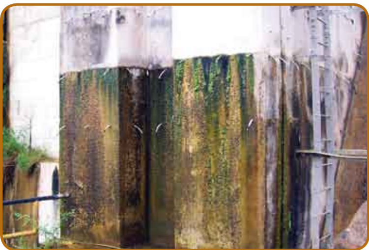
Percolação da água através de junta de construção
