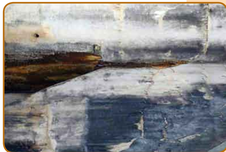
Fissuras em Contraforte
