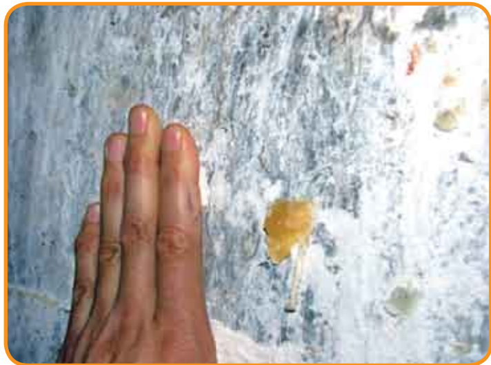
Figura 1 – Gel exsudado na superfície do concreto em galeria de eclusa.
