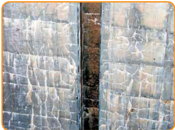
Figura 5 – Fissuração tipo mapa em parede de eclusa.
