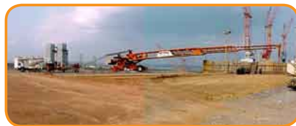
Figura 23 – Equipamento com a correia transportadora em plano praticamente horizontal, lançando concreto, visto no instante em que o caminhão está posicionado para o abastecimento do silo receptor.
