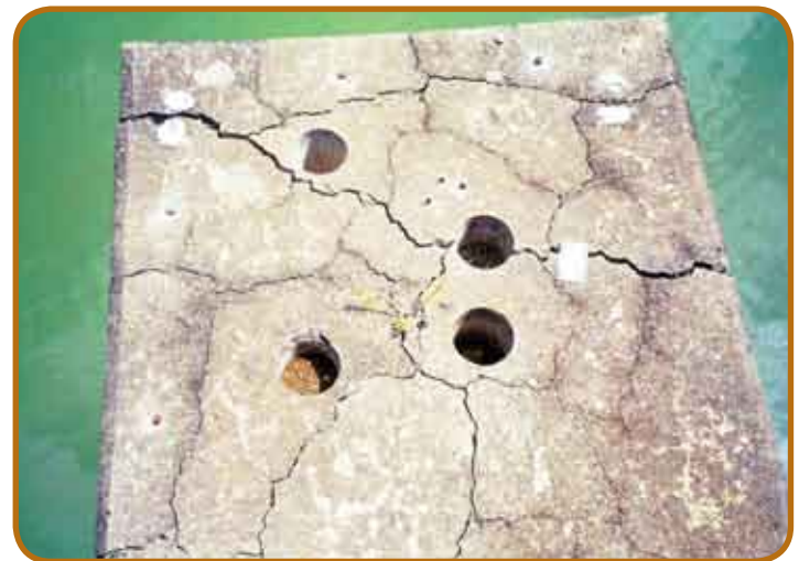
Cabeça de pilar afetada por reatividade álcalis-agregado
