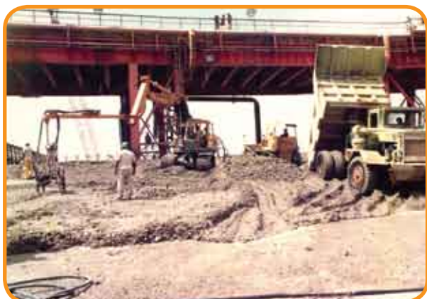
Figura 22 – Lançamento de concreto massa em rampa, com caminhão fora de estrada basculante e adensamento com bateria de vibradores, acoplada na extremidade da lança de retroescavadeira.
