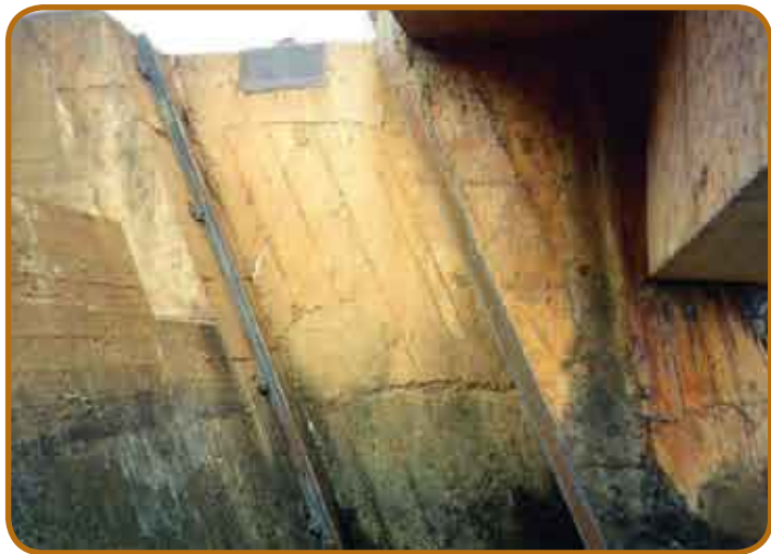
Guia de Stop-log: segregação e acabamento "pobre"
