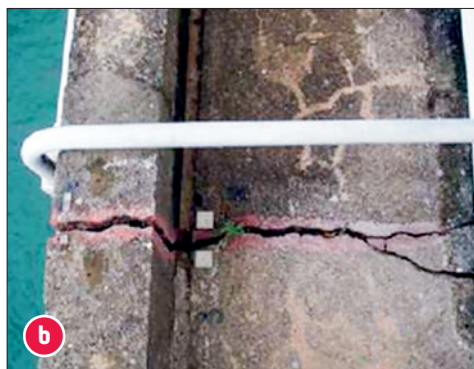
Abertura expressiva de fissura no concreto
