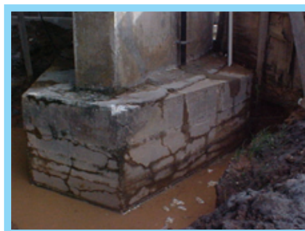
Figura 2 - Bloco de fundação de edifício. Nota-se fissuras em forma de mapa na lateral e na parte superior.
