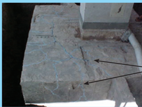
Figura 3 - Bloco de fundação de edifício. Nota-se fissuras em forma de mapa na lateral e na parte superior. Algumas fissuras foram destacadas para a foto, por meio de giz azul.
