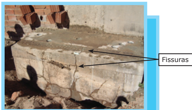
Figura 1 - Bloco de fundação de edifício. Nota-se fissuras em forma de mapa na lateral e na parte superior.
