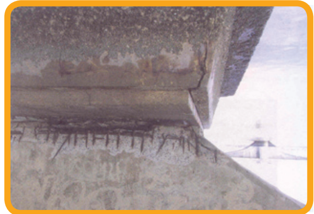
Corrosão de armaduras por cloretos em apoio de ponte rodoviária
