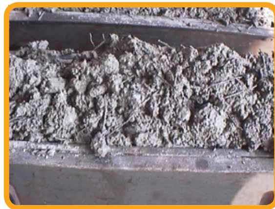
Detalhe para a distribuição e ou homogeneização das fibras no concreto.
