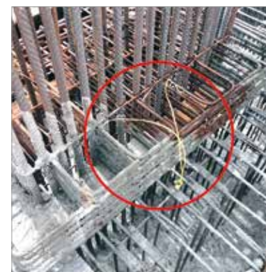
► Figura 15 Termopares instalados nas armaduras antes da concretagem de uma estrutura de fundação
