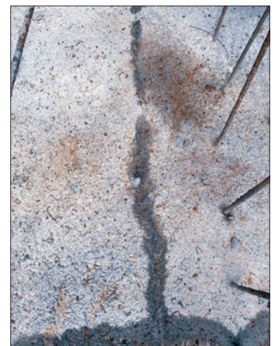
► Figura 11 Detalhe da fissura no bloco, observada em campo
